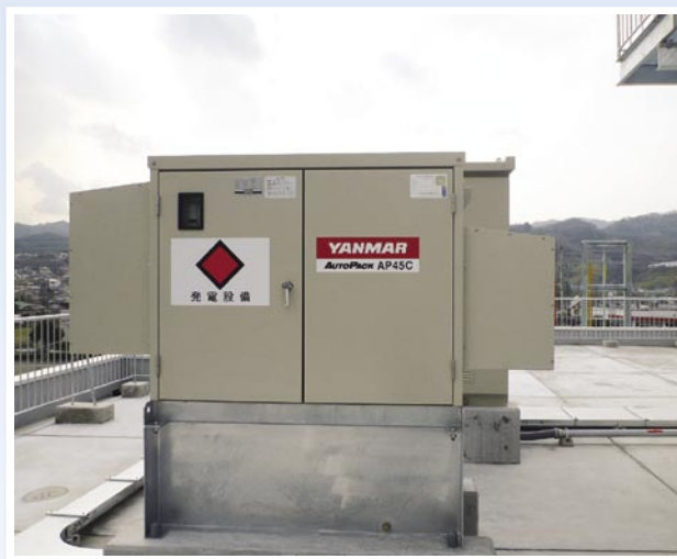
自家発電設備
